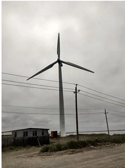
Рис. 2.5.1. Один из ветрогенераторов в составе ветроэнергетической станции на территории пос. Октябрьский полуострова Камчатка
